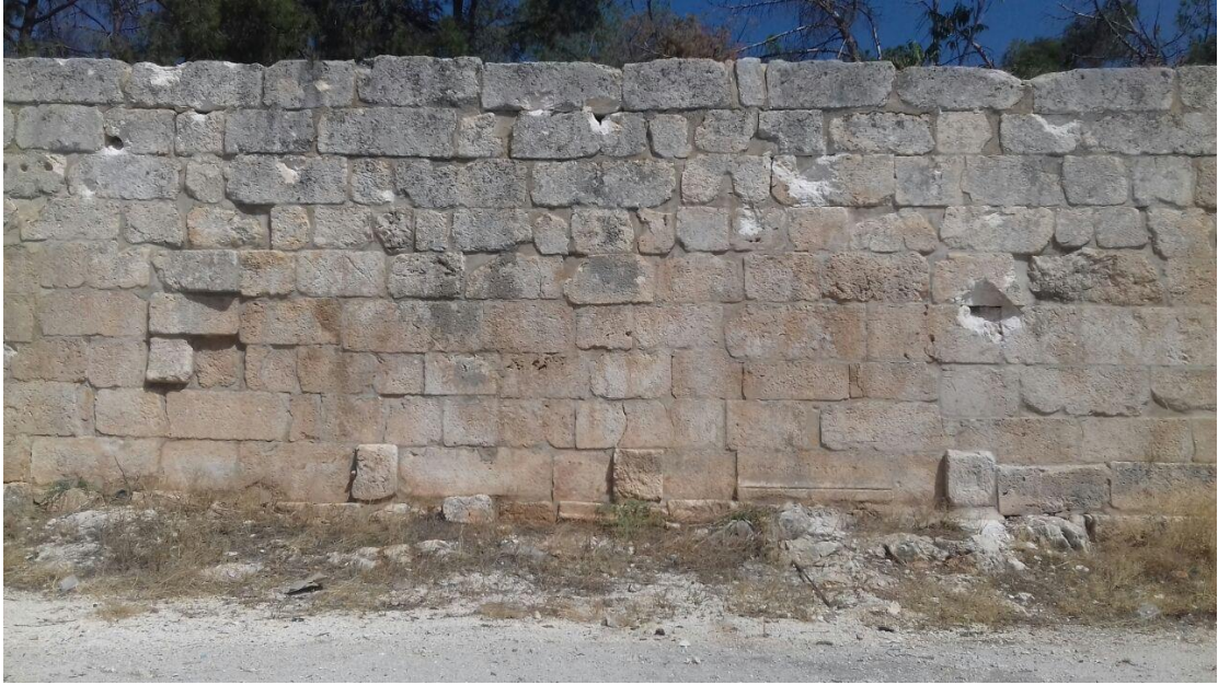
أضرار لحقت بالجدار الخارجي (الصورة مواجهة للغرب)
