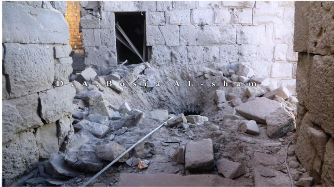
الحفرة الملاصقة للبرج الخامس والتي أحدثها القصف بالبراميل المتفجرة
