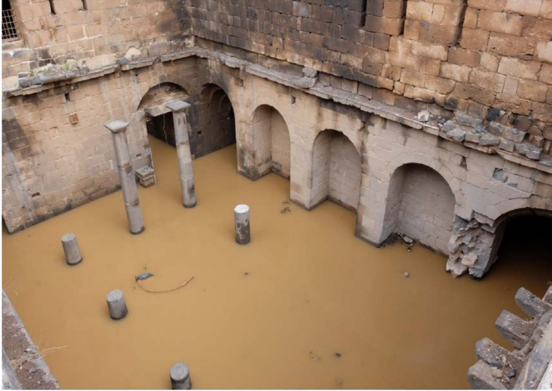
صورة توضيحية من زاوية أخرى للباحة السماوية الغربية وهي مغمورة بالمياه ونلاحظ الجزء المدمر نتيجة القصف الجوي
