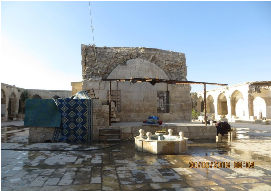
الجهة الغربية ويظهر فيها المسجد بعد إزالة بقايا القبة والتكية من الجهة الشمالية والجزء المتبقي من القبة بعد إزالة الجزء الضعيف
