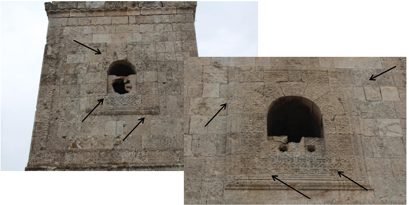
تفتت زخارف المئذنة وتكسر بعض أطرافها بفعل الشظايا - الواجهة الغربية
