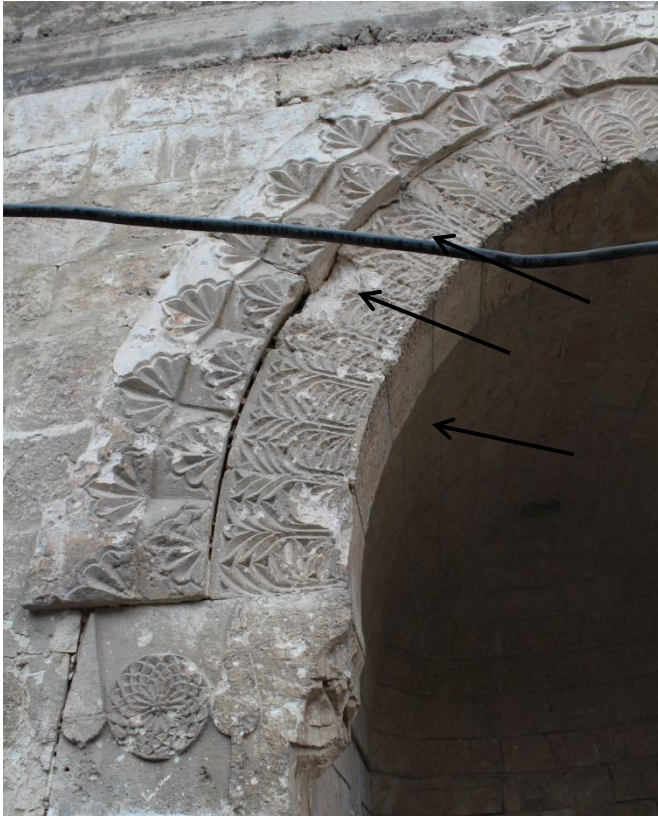
صورة لتشققات أحجار قوس المدخل الشرقي
