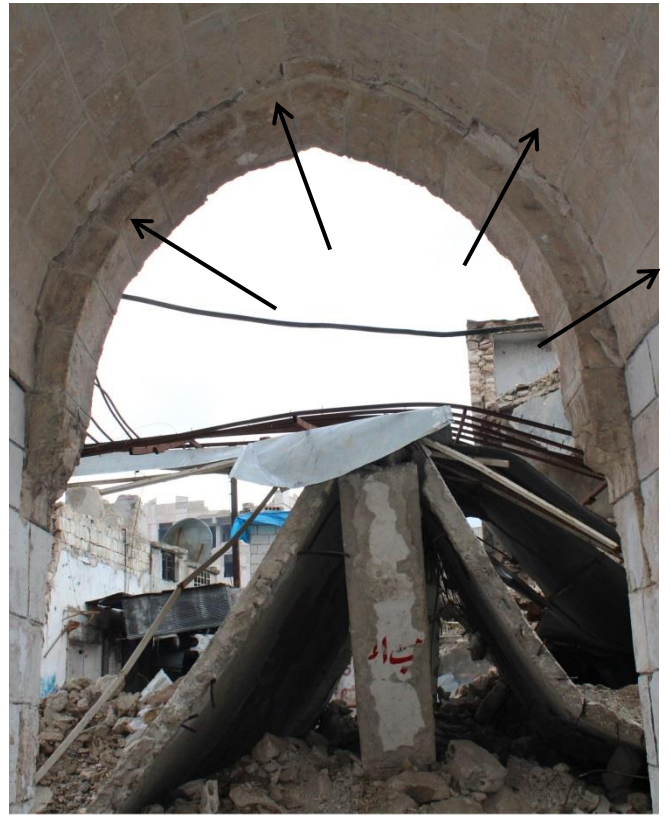
صورة لتشققات قوس المدخل الشرقي من الداخل
