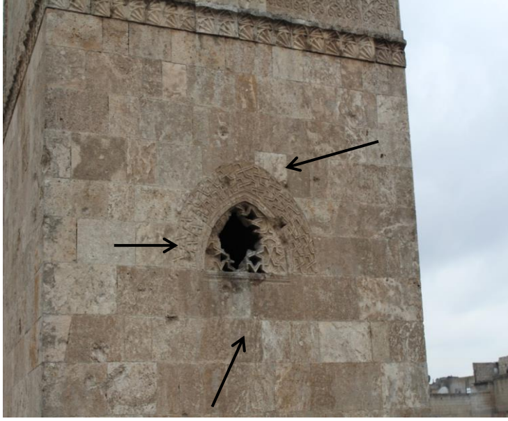
تضرر زخارف المنذنة - الواجهة الشرقية
