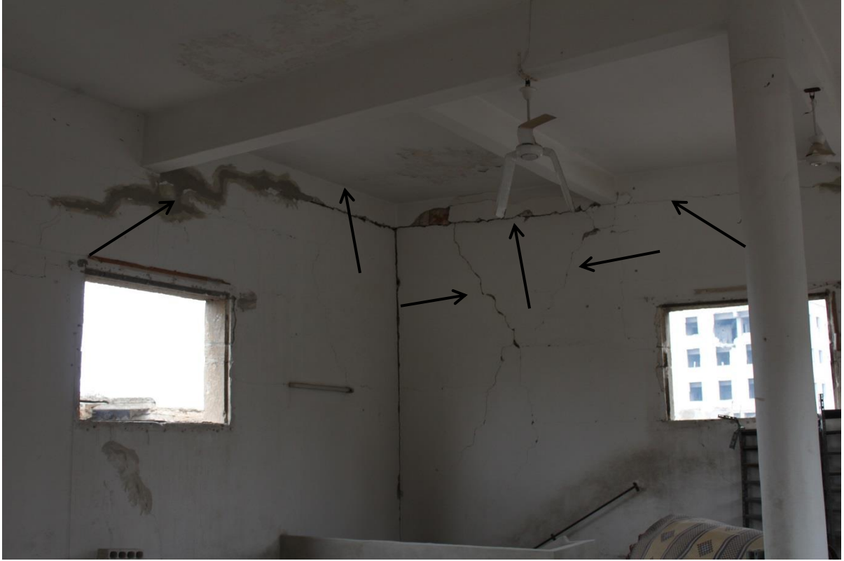
صورة لتشققات الزاوية الشمالية الشرقية من داخل الطابق الثاني
